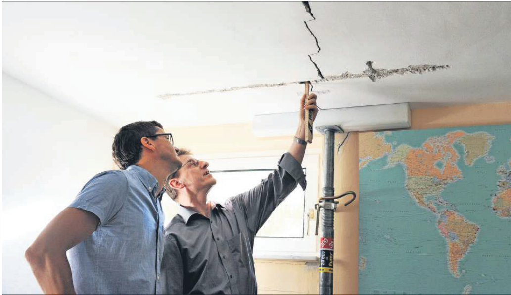
Wer bezahlt die Schäden in den Böblinger Häusern? Werner Schubert (l.) und Dieter Eger von der IG Erdhebungen begutachten Risse in einem Kellergeschoss Foto: Thomas Bischoff/Archi
